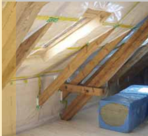
Wo Bauteile die Dämmung durchdringen, ist eine Qualitätskontrolle punkto Luftdichtigkeit nötig.
