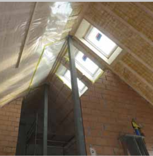
Drei Phasen im Arbeitsablauf: rechts oben die Zwischensparrendämmung, links oben die Dampfbremse (Folie), in der Flucht der Fenster nach hinten der Lattenrost zur Montage der Innenverkleidung.
