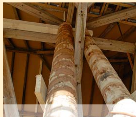
Rundhölzer stabilisieren das auf „Stelzen“ stehende Dach, das vom alten Ökonomiegebäude erhalten bleiben soll.
